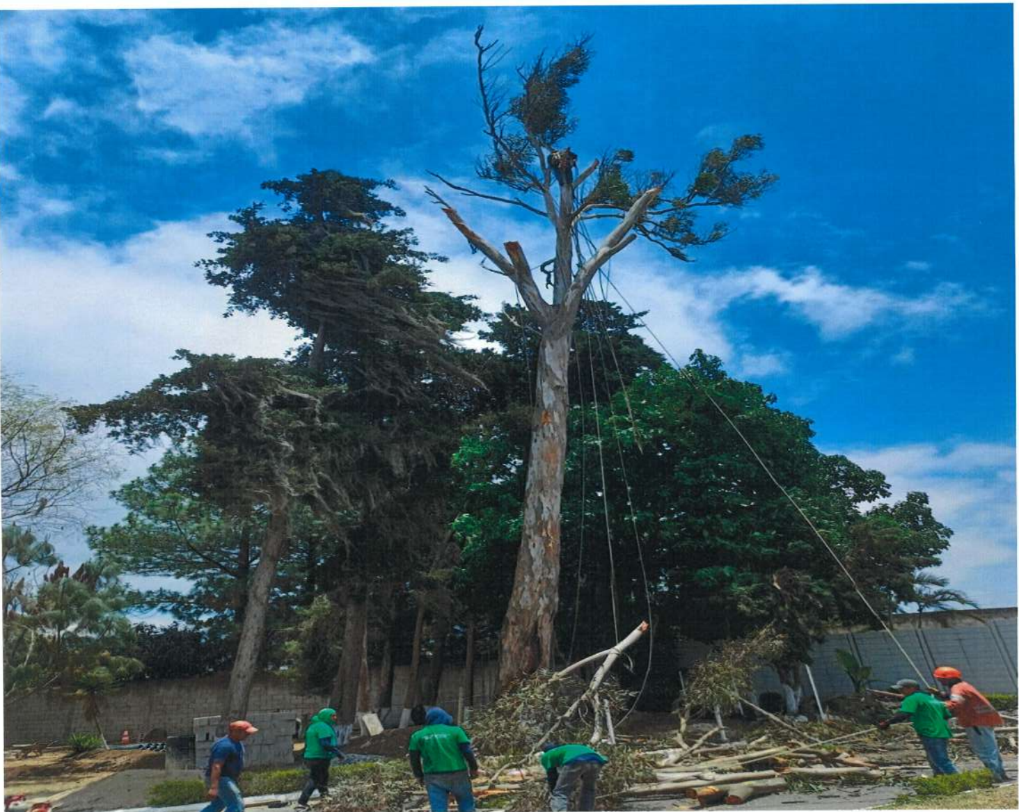
TAJA DE ÁRBOL EUCALIPTO PRESENTA FISURAS
